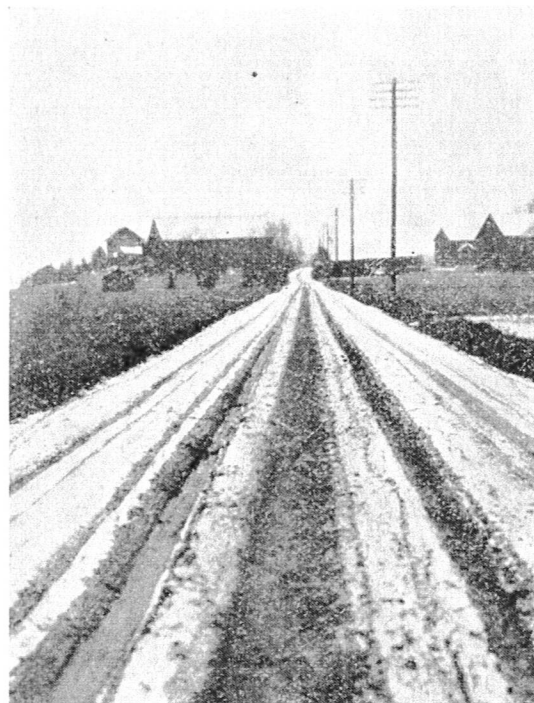
Fig. 11. Spordannelse i pukveier (som følge av hestetrafik). Chausseen Berg—Fredrikshald.
